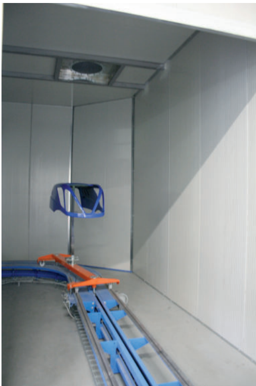
22 – La cabina di raffreddamento.
