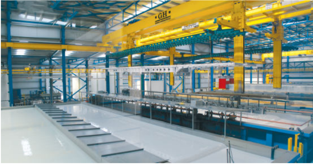
2 – Una vista delle vasche di pretrattamento nanotecnologico e applicazione della cataforesi. Une vue des cuves du prétraitement et application de la cataphorèse.
