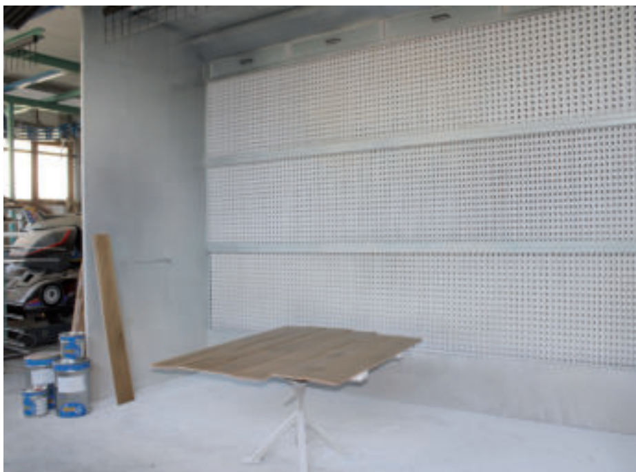
9 - La zona di verniciatura dotata di una cabina manuale con filtro a secco.
